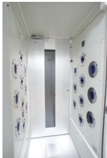
動物舎入口に設置のエアシャワー
