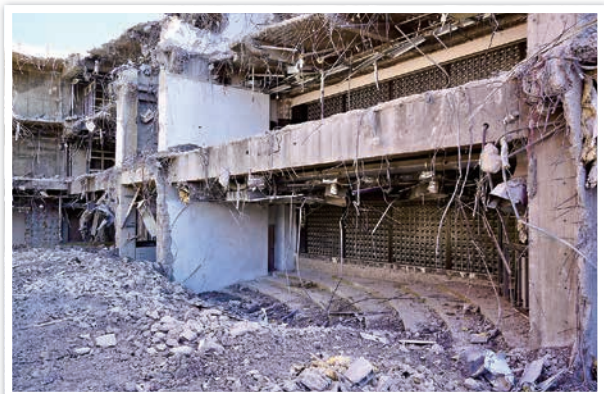
コンクリートの欠片に埋もれた第1教室と第2教室。(07.18.2021)
