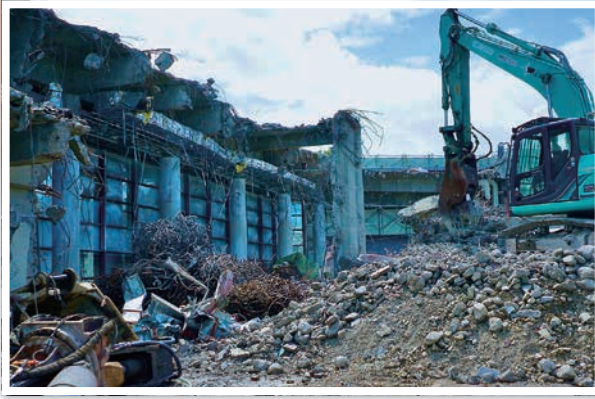
青空の下。天井のない講堂。油圧ショベルのフォークグラップルが壁を壊していく。(07.27.2019)
