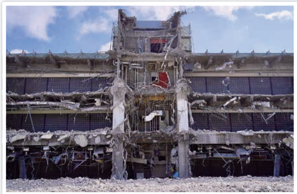
実習講義棟の北側。壁面だけが残る。(07.18.2021)
