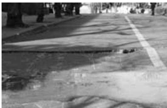
地震により地割れが発生した教養棟と大駐車場間の道路:平成23年3月11日（金）
