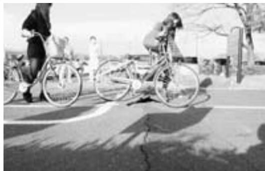
地震によりアスファルトが割れて隆起した大駐車場入り口の道路:平成23年3月11日(金)
