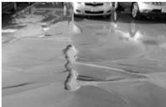
液状化で広範囲に渡って水と泥砂で覆われた千葉校舎大駐車場:平成23年3月11日(金)
